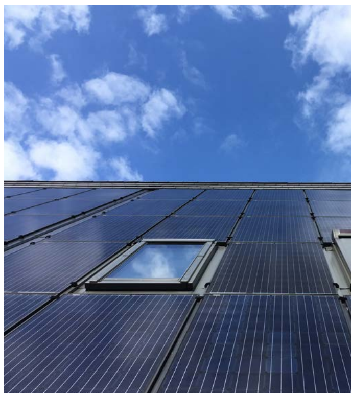
De dakramen van de woningen in Groevenbeek-Noord (Ermelo) passen naadloos in het PV-dak. Een geïntegreerde chip in het dakraam, ook werkend op PV, communiceert met andere apparaten in huis en regelt de automatische buitenzonwering.
